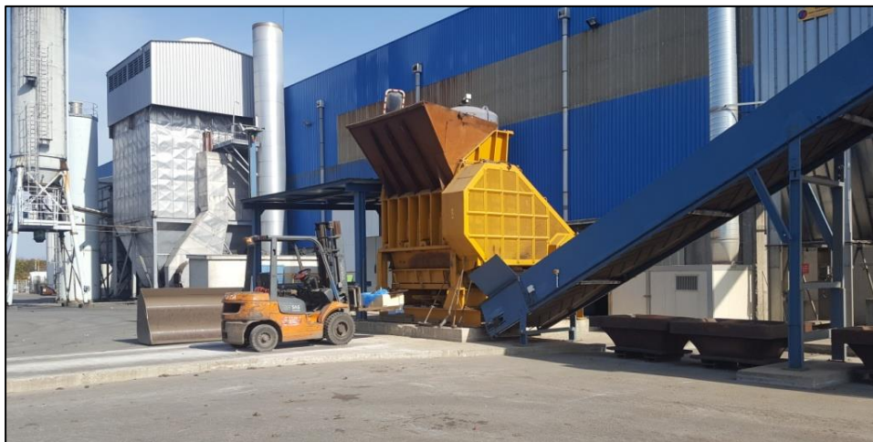
Broyeur MTB en aval de la ligne de tri mécaniques des RB
